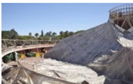
Figura 4 - Lona do Auditório Desmorona (Parte Externa)
