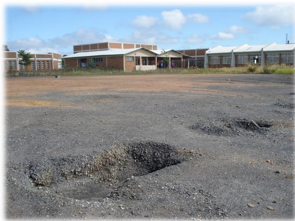
Figura 6 - Área do Câmpus com rejeitos de carvão expostos
