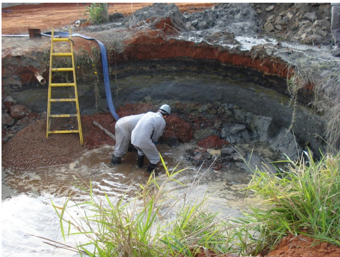
Figura 25 - Água subterrânea aflorando durante a escavação.
