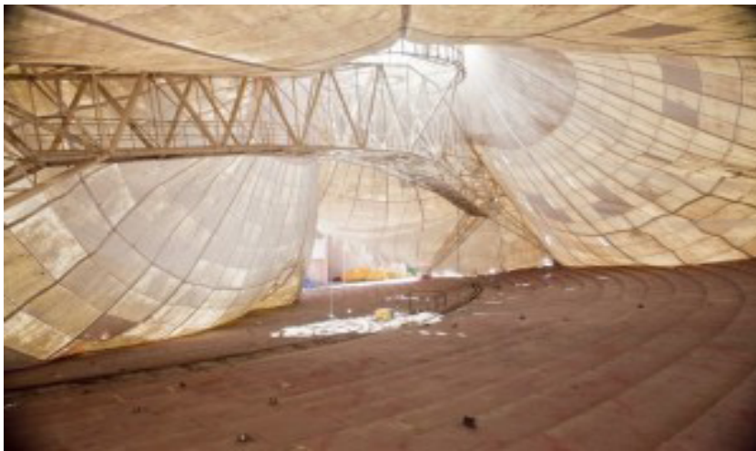
Figura 5 - Lona do Auditório Desmorona (Parte Interna) FONTE: Ribeiro (2012)
