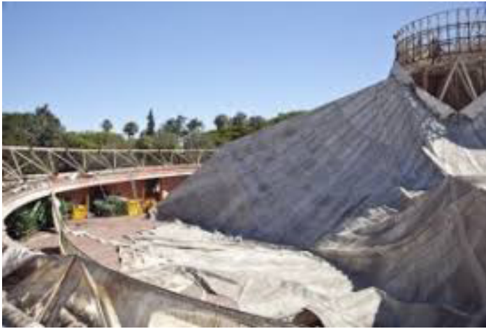
Figura 4 - Lona do Auditório Desmorona (Parte Externa) FONTE: Ribeiro (2012)
